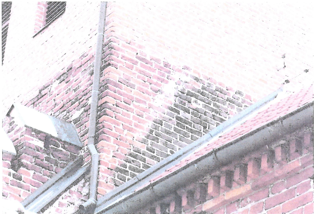
Fot.20 Ślad po pierwotnym dachu na wschodniej elewacji wieży.
