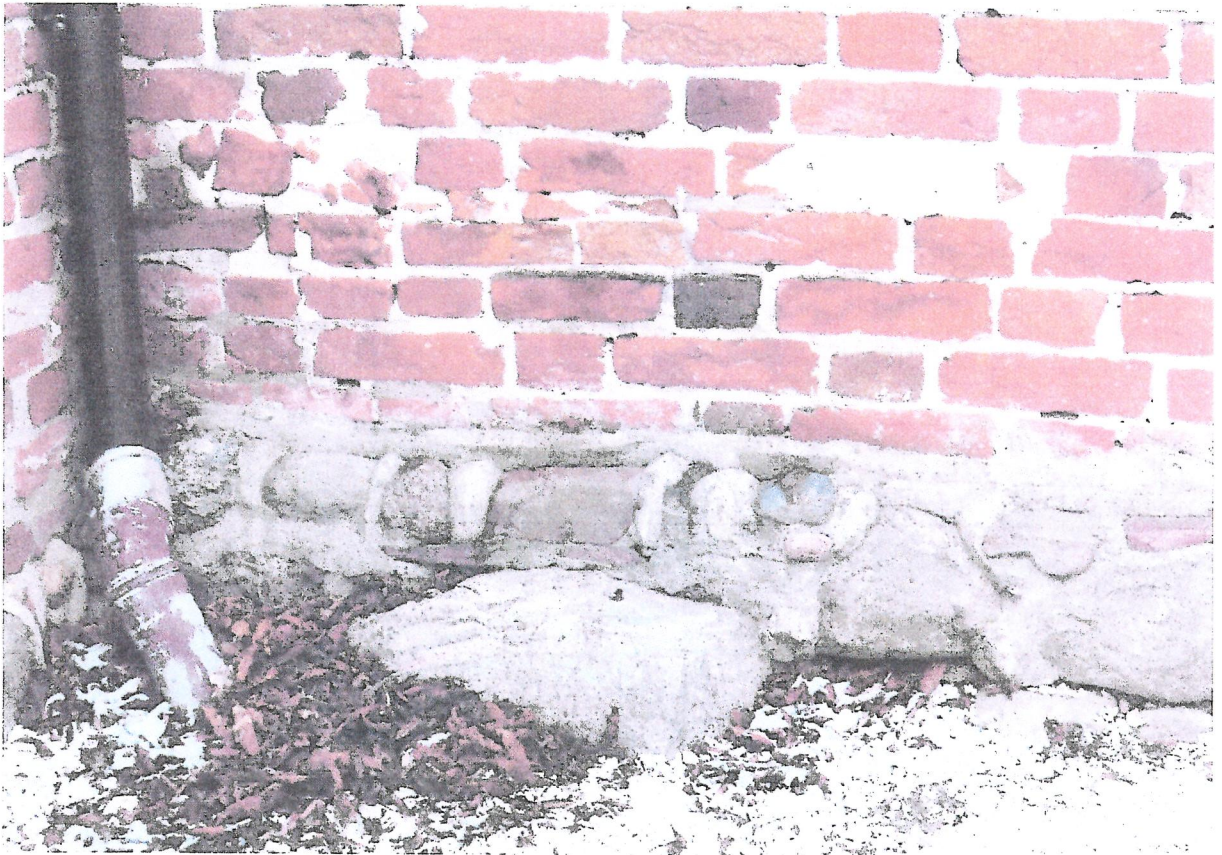
Fot.22 Przemurowania i wtórne naprawy w obrębie strefy cokołowej elewacji południowej.
