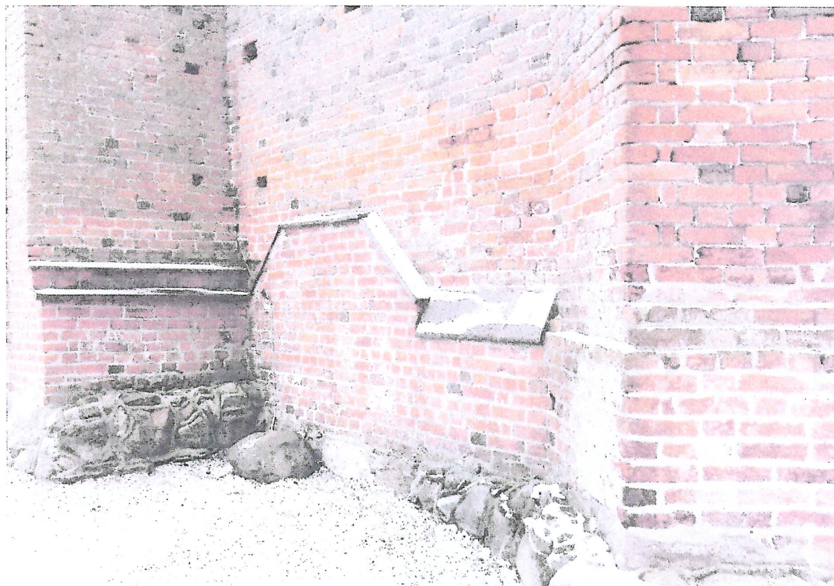
Fot.8 Wtórna odsadzka w obrębie cokołu wieży kościoła.
