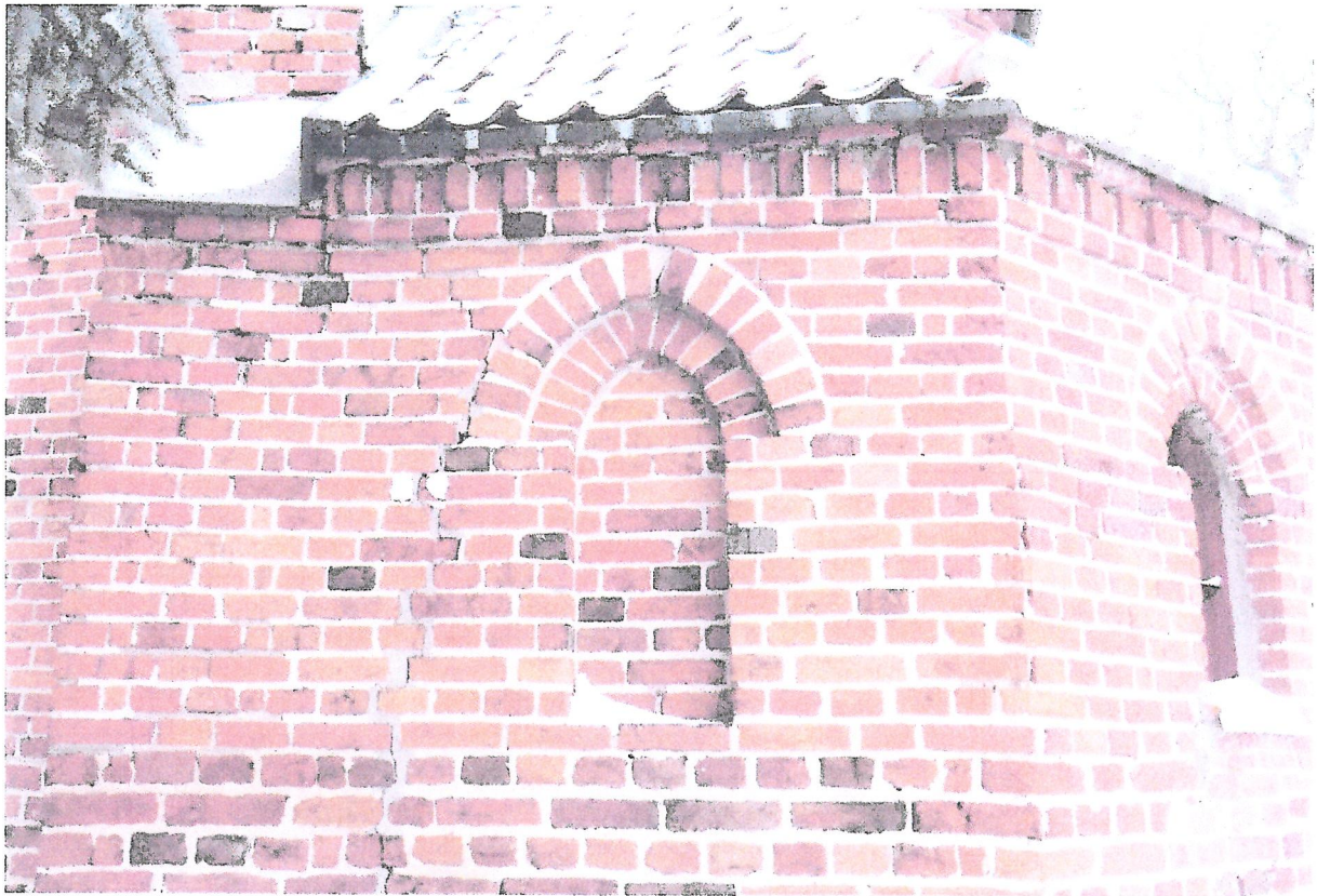
Fot.18 Spękania w obrębie prezbiterium kościoła.
