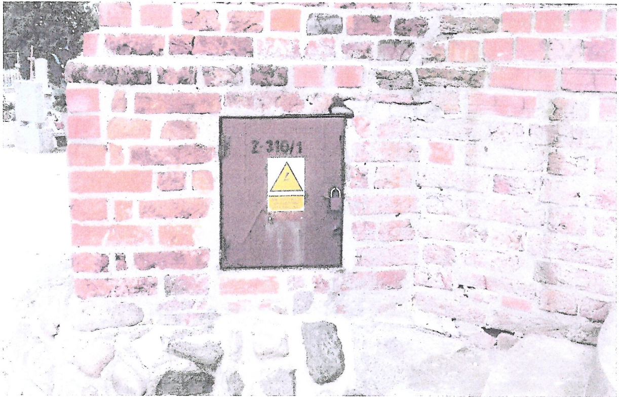
Fot.29 Skrzynka prądowa u dołu przypory pn.-zach.
