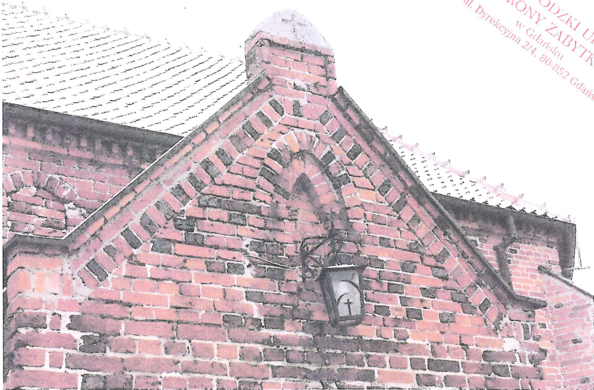
Fot.33 Szczyt kruchty południowej. Układ oraz wielkość cegieł potwierdzają późniejsze wykonanie tego elementu.
