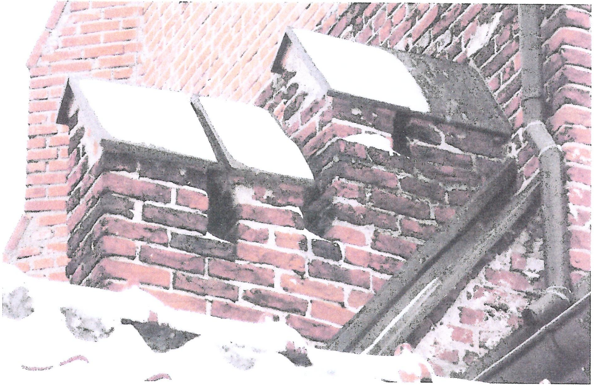
Fot.21 Sterczyny z przebarwieniami wstęgu ceglanego. Prawdopodobnie efekt pożaru dachu świątyni.
