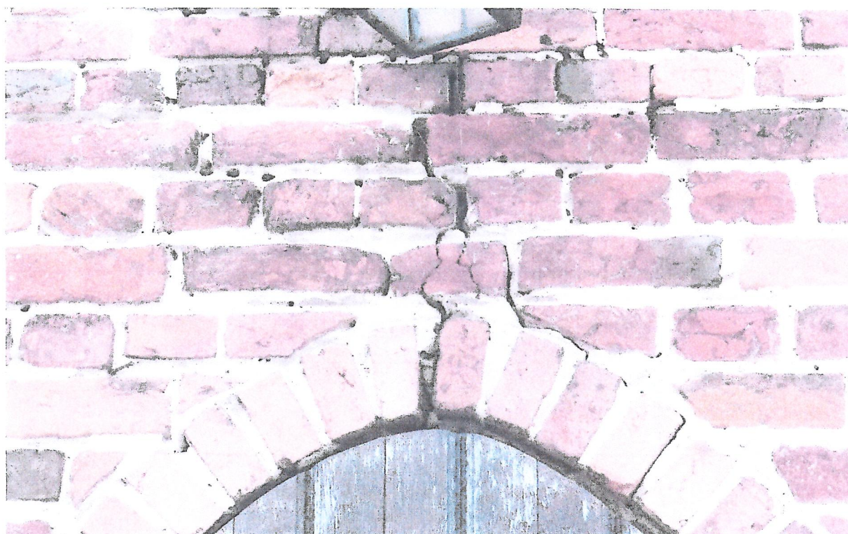
Fot.32 Pęknięcie muru nad wejściem do kruchty południowej.
