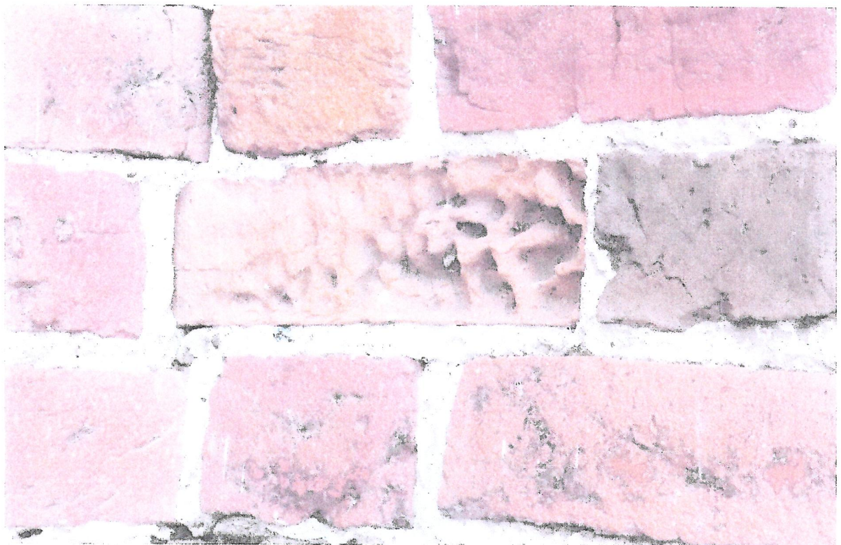
Fot.24 Destrukcja powierzchni cegły. Przykład z elewacji południowej.
