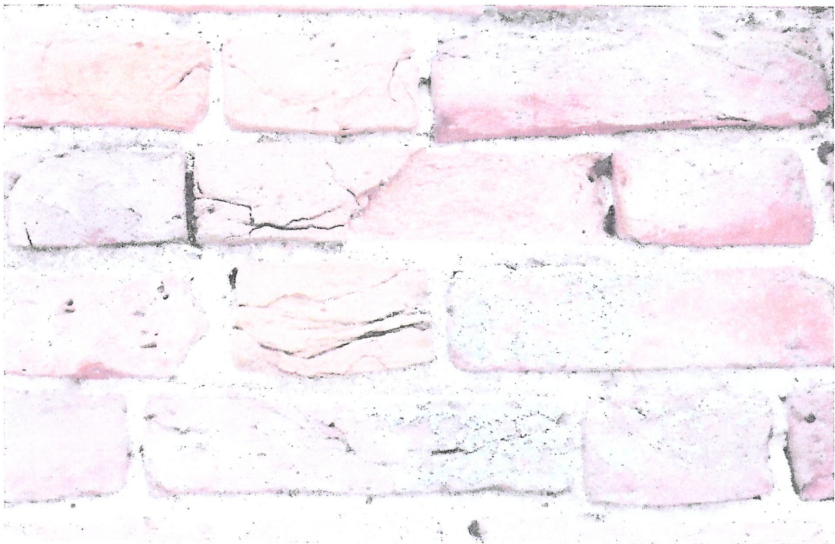
Fot.14 Destrukcja powierzchni cegieł na elewacji północnej.
