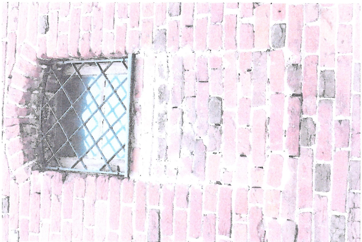
Fot.26 Zamurowany fragment okna na południowej elewacji wieży.
