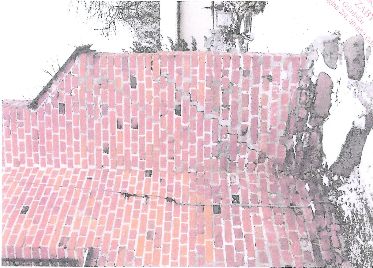
Fot.17 Przypora prezbiterium. Widoczne pęknięcia muru wypełnione zaprawą cementową.
