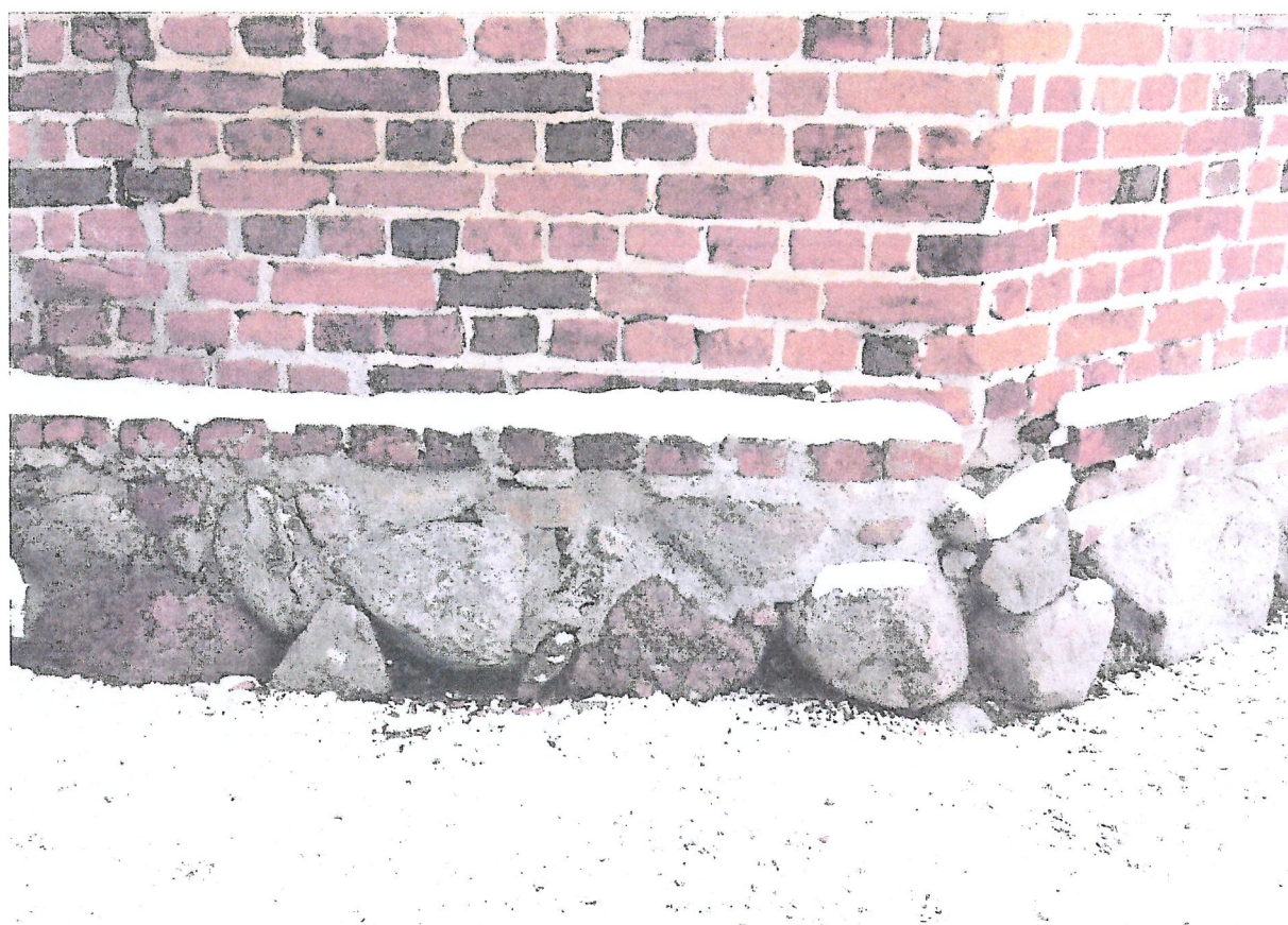
Fot.16 Strefa cokołowa prezbiterium. Widoczne pęknięcia wypełnione zaprawą cementową.
