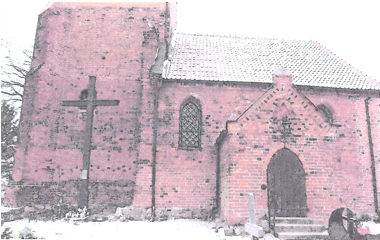
Fot.6 Elewacja południowa kościoła. Widoczne różnice kolorystyczne wstęgu ceglanych w miejscach przeróbek i napraw.
